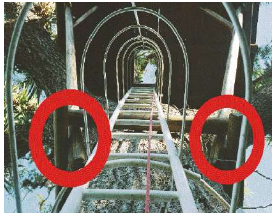
Figura 200 – Destaque para o sistema de fixação do mirante de madeira instalado sobre o jequitibá centenário sem uso de pregos, parafusos ou vergalhões.
