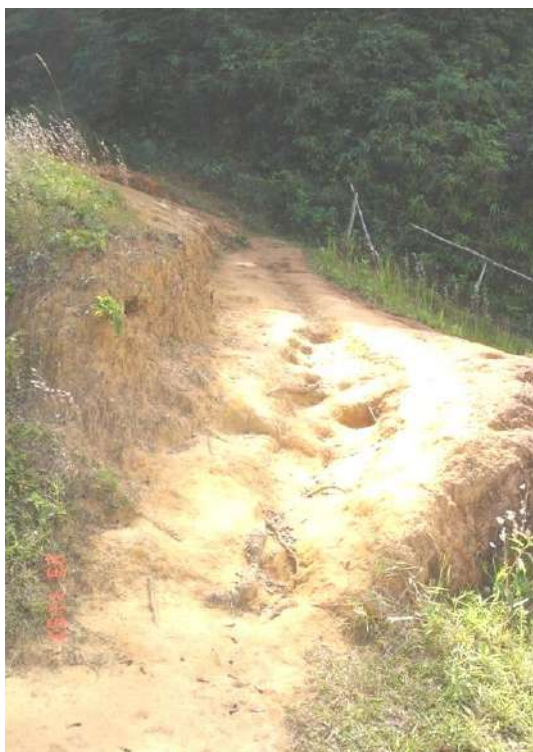
Figura 246 – Processos erosivos identificados na trilha de acesso a Cac. do Country. Foto: Edson Valpassos
